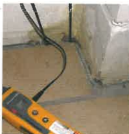
Hohe elektrische Leitfähigkeit im Mauerwerk ist ein Indiz für Feuchteschäden.
