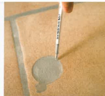
Mit einzelnen Kernbohrungen im Boden ging der Baubiologe auf Schimmel-Suche.
